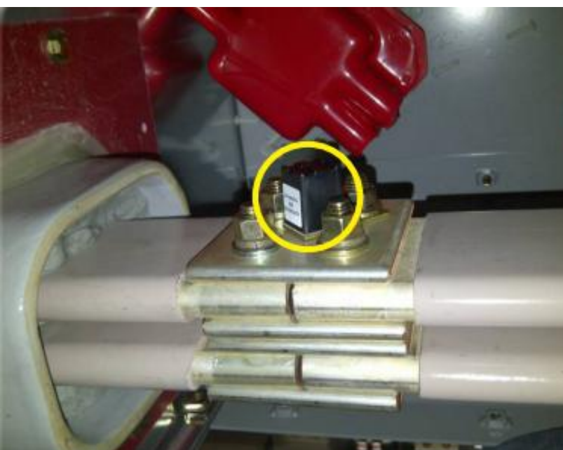
Mô-đun cảm biến được gắn cố định lên busbar
