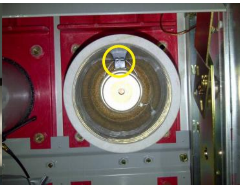
Cảm biến được lắp cố định tại tiếp điểm máy cắt
